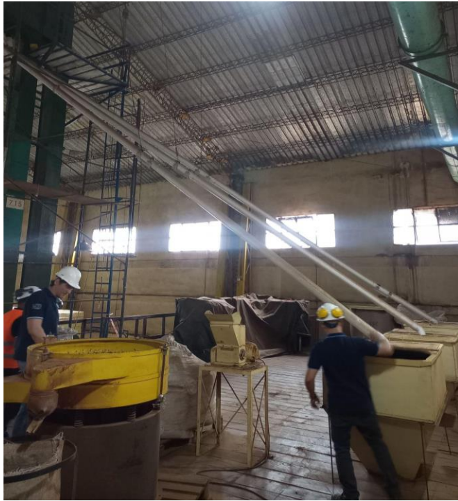
Figura 9. Chequeos en el sistema de distribución
