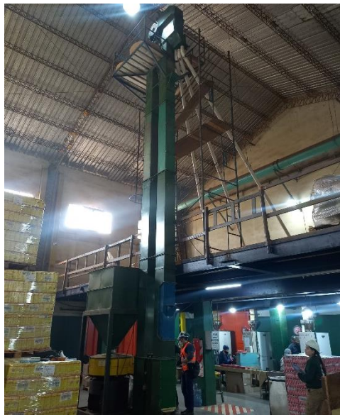
Figura 3. Vista general del sistema completo de alimentación de tolvas instalado en planta.
