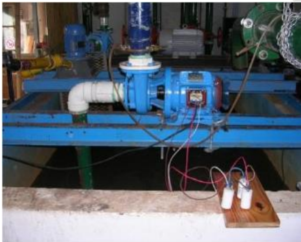
Bomba ensayada como turbina.
