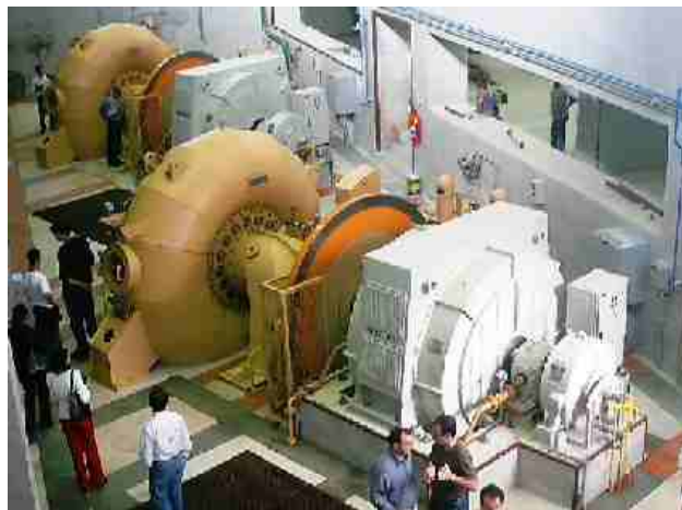
Figura 4: PAH con turbinas tipo Francis de eje Horizontal (Brasil)
