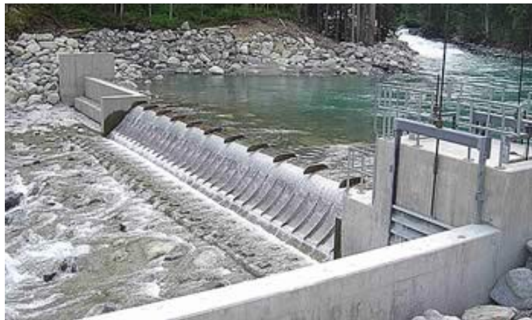
Figura 3: Obra de toma con Rejilla auto-limpiante tipo Coanda
