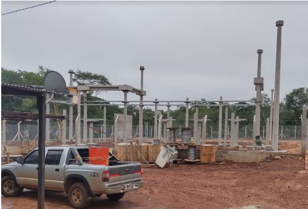
Fig. 5. Sub Estación Transformador Alem Sur.
