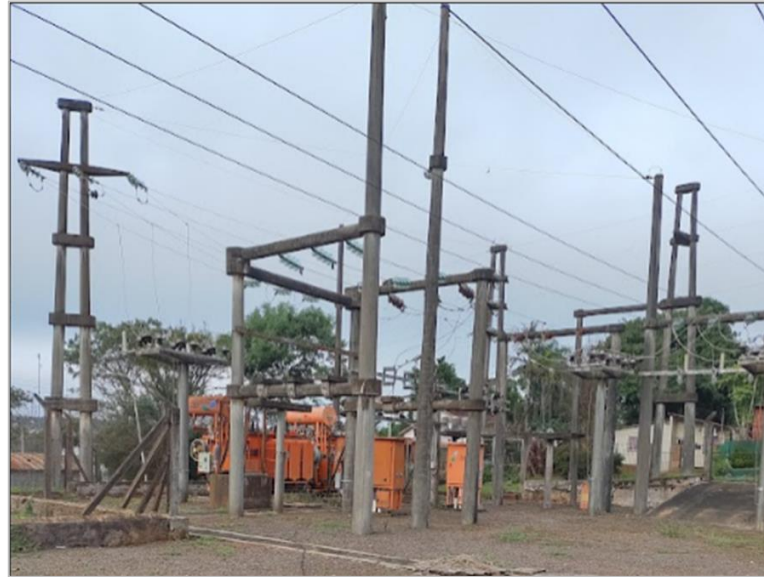
Fig. 3. Sub Estación Transformadora Alem Centro.
