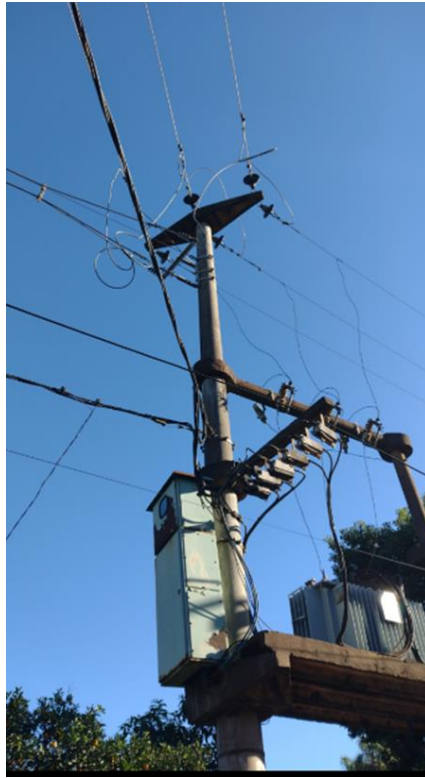
Fig. 7. Sub Estacion Transformadora Aerea (SETA) relevada.
