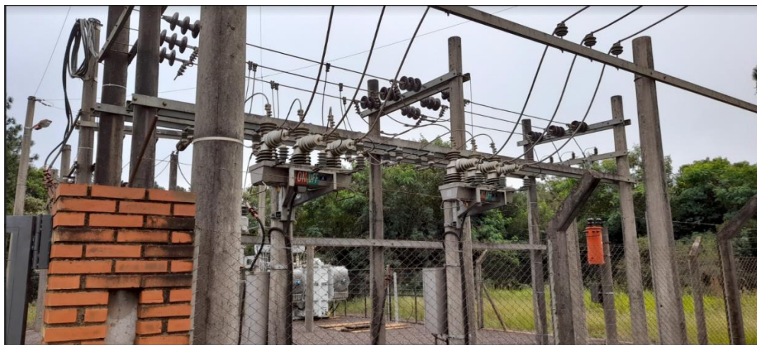
Fig. 4. Sub Estación Transformadora Alem Norte
