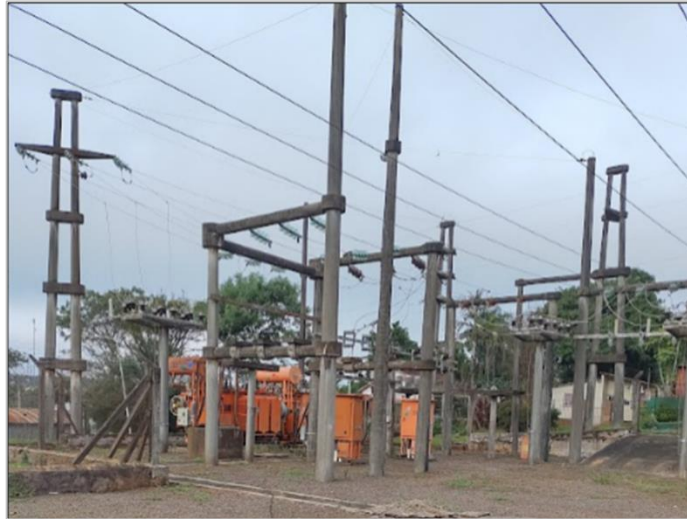
Fig. 2. Sub Estación Transformadora Alem Centro.
