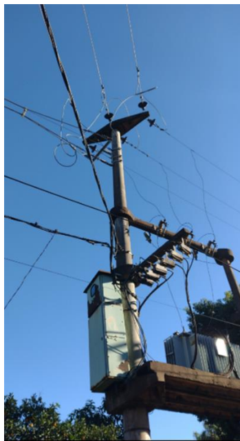
Fig. 7. Sub Estación Transformadora Aérea (SETA) relevada. [3]
