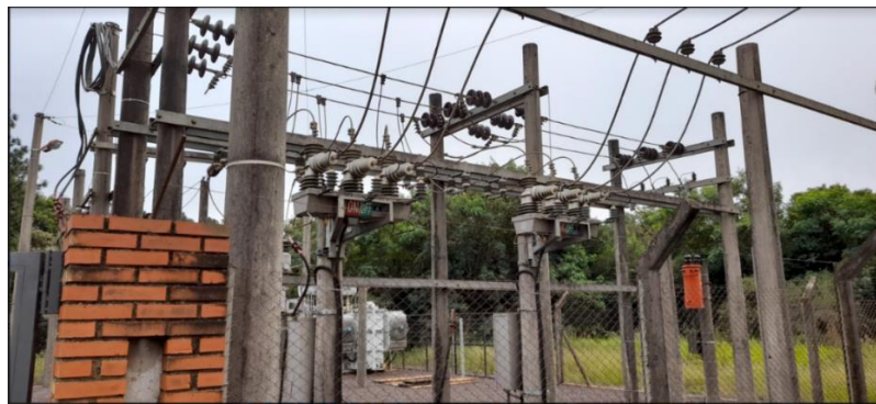
Fig. 3. Sub Estación Transformadora Alem Norte [3]
