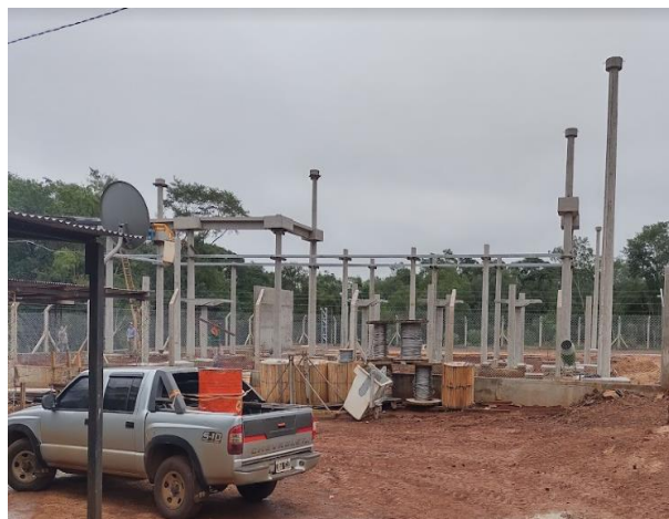
Fig. 4. Sub Estación Transformador Alem Sur (En etapa de construcción). [3]
