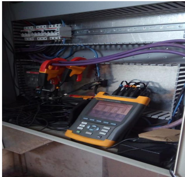
Fig. 2. Analizador de red Fluke 434 conectado en el tablero seccional de la FIO.
