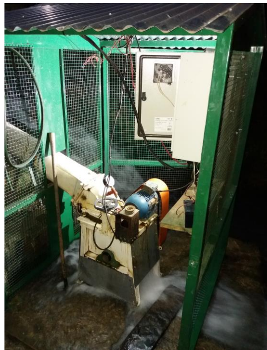
Fig. 10 - Vista de la turbina generando. Fuente: elaboración propia
