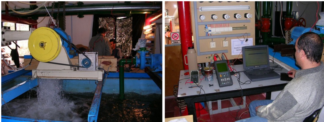
Fig.8. Vista de grupo turbina-generador y vista banco de resistencias y medición
