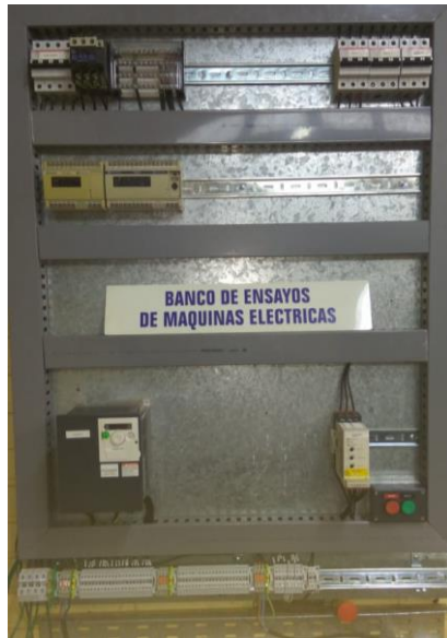
Fig. 5 – Tablero Eléctrico desarrollado para Accionamiento de las MER
