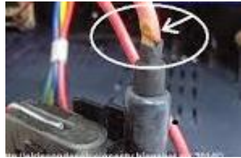
Fig. 4. (b) Falla de aislación
