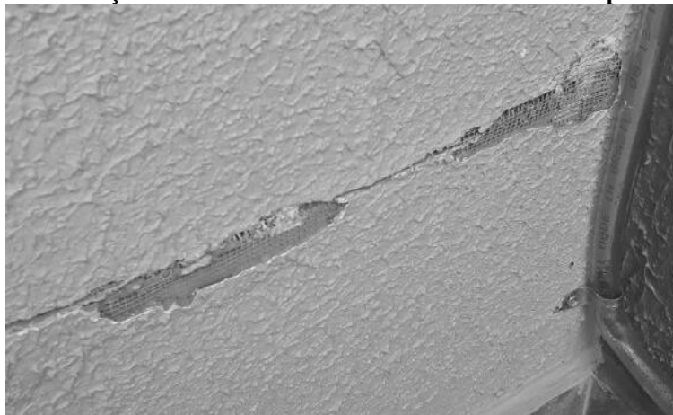
Figura 5 – Fissuração de descolamento no revestimento acrílico da parede externa.
