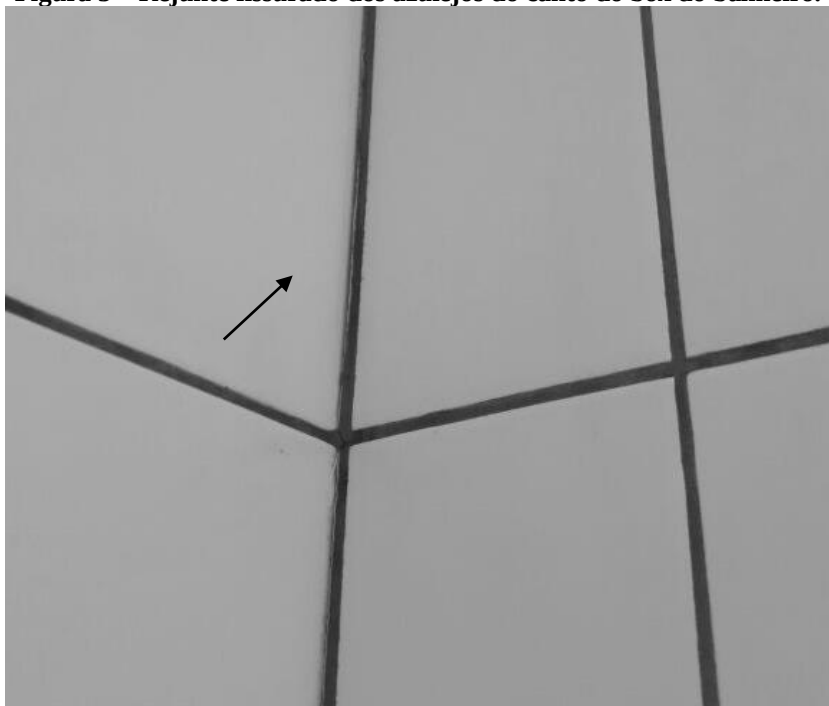
Figura 3 – Rejunte fissurado dos azulejos do canto do box do banheiro.
