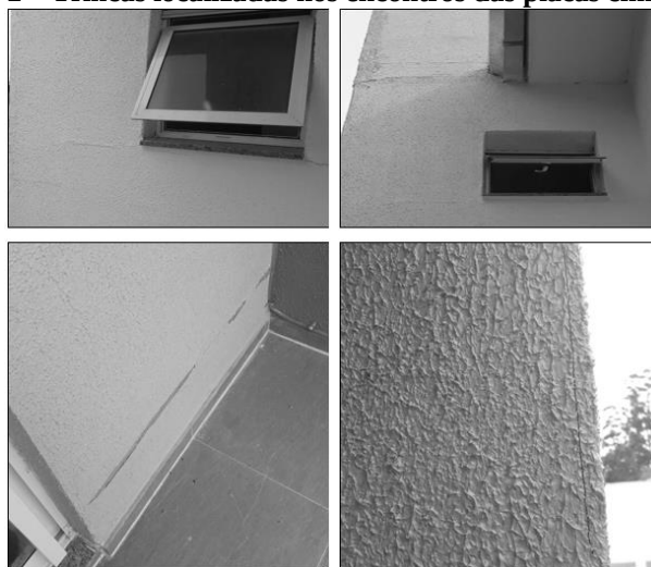
Figura 2 – Trincas localizadas nos encontros das placas cimentícias.
