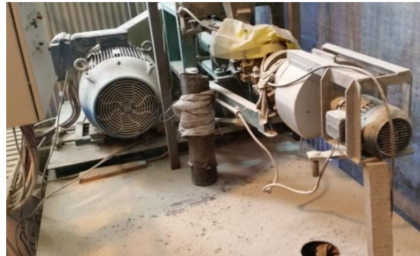
Figura 13: Polvo sobre maquinas
