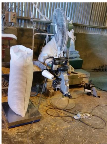
Figura 19: Conexiones de electricidad irregulares.
