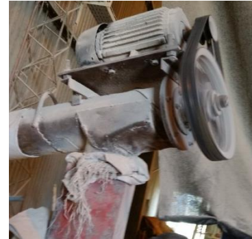
Figura 10: Polea sin protección.
