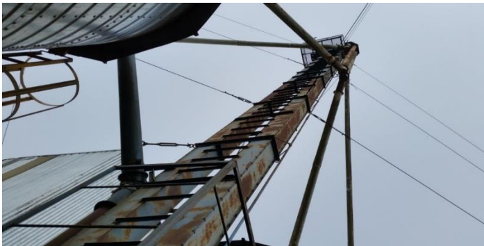
Figura 1: Escalera de la noria de distribución sin la protección.
