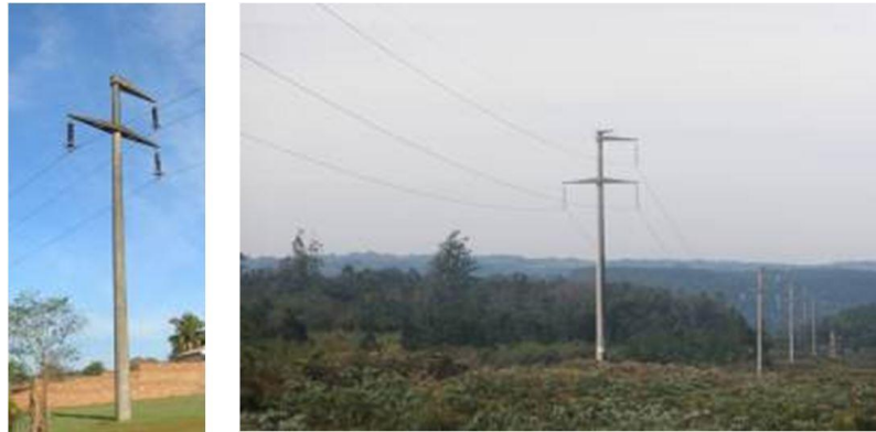
Figura 1: Línea de 132kV. Aristóbulo del Valle, Provincia de Misiones, Argentina.
